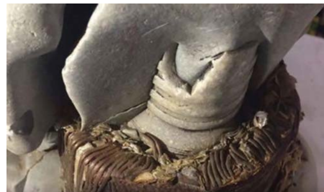
Рис. 79. Остатки медных проводов на трансформаторе
